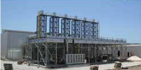
TİRENDA DOĞALGAZ CEVRİM SANTRALİ
