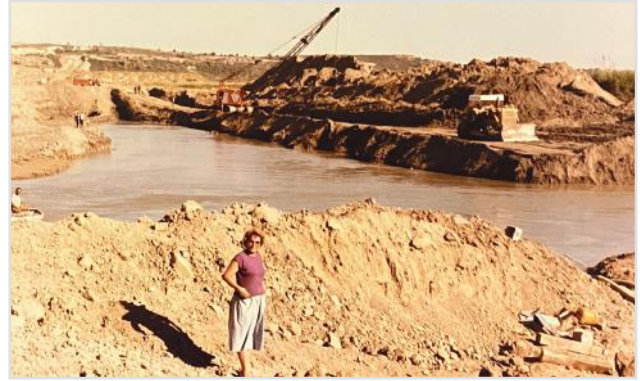
Yumurtalık-Kırıkkale Petrol Boru Hattı, Üç Pompa İstasyonu, Orta Anadolu Rafinerisi Kurulum Çalışmaları, 1985-1987
