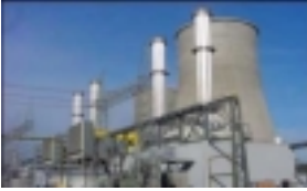
Bir doğalgaz santrali
