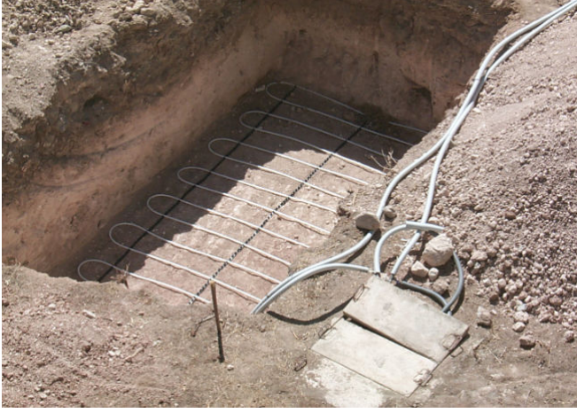
Şekil 3. Toprak Isı Değiştiricisinin Fotoğrafı
