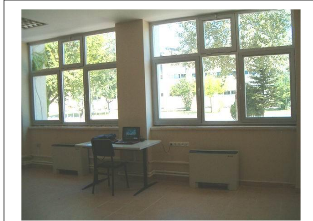
Şekil 2. Konfor Odası ve Isı Dağıtım Sistemi [10]
