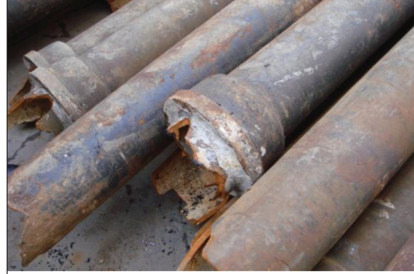
Şekil 2. İçme suyu şebekesinden sökülen metal su boruları[8]
