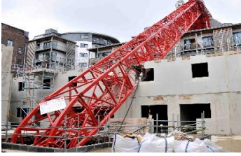
Şekil 2.2- Kurulduktan sonra çöken bir kule vinci
