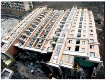
Şekil 2.3- Temelindeki kusur nedeni ile devrilmiş bina!
