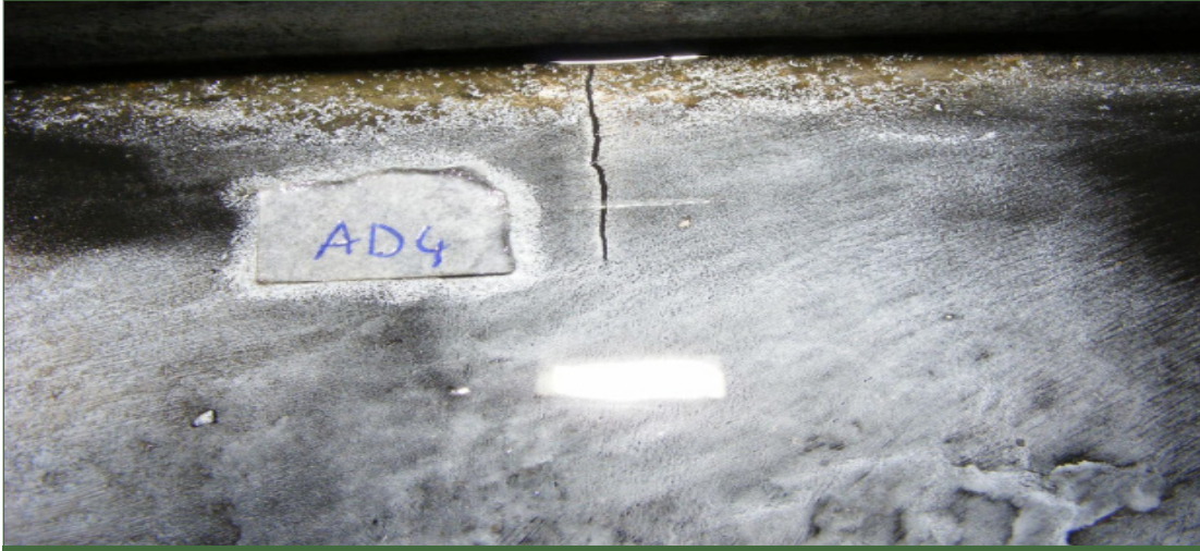
Şekil 5. Yorulma Çatlağı Örneği
