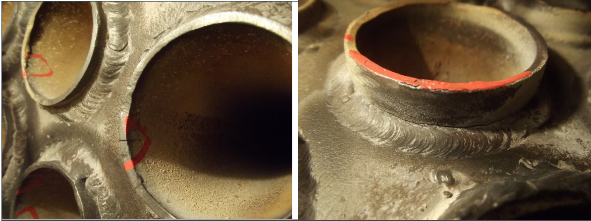
Şekil 6. Buhar Kazanı Alev Duman Borusu ve Ayna Bağlantılarında Saptanan Çatlaklar
