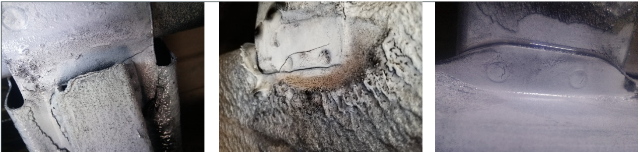
Ana şasi kolunda çatlak
