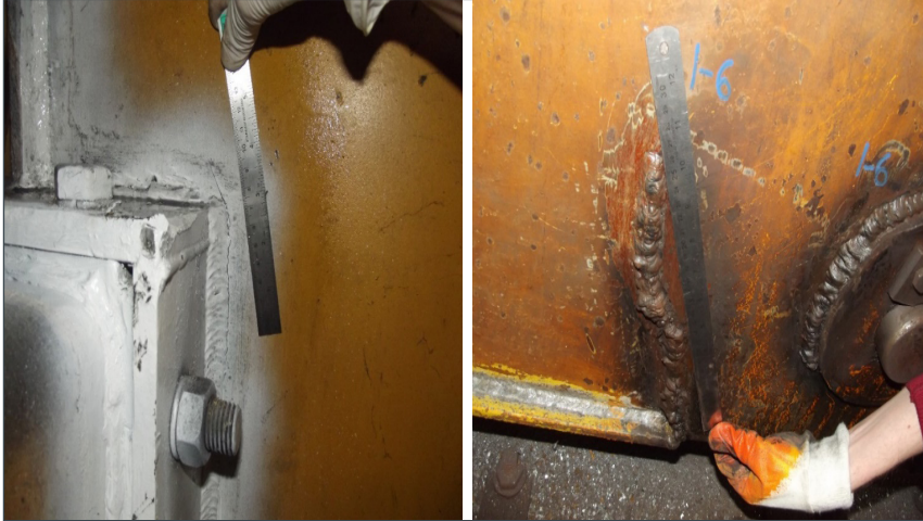
Şekil 5. Vinç Kirişlerinde Gözlenen Çatlaklar
