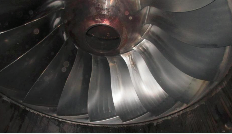
Fotoğraf 2. Ünite Çark Kanatlarının Emme Borusu
