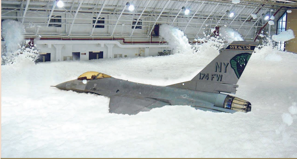
Şekil 2. Bir Uçak Hangarında Köpüklü Yangın Söndürme Sistemi Uygulaması
