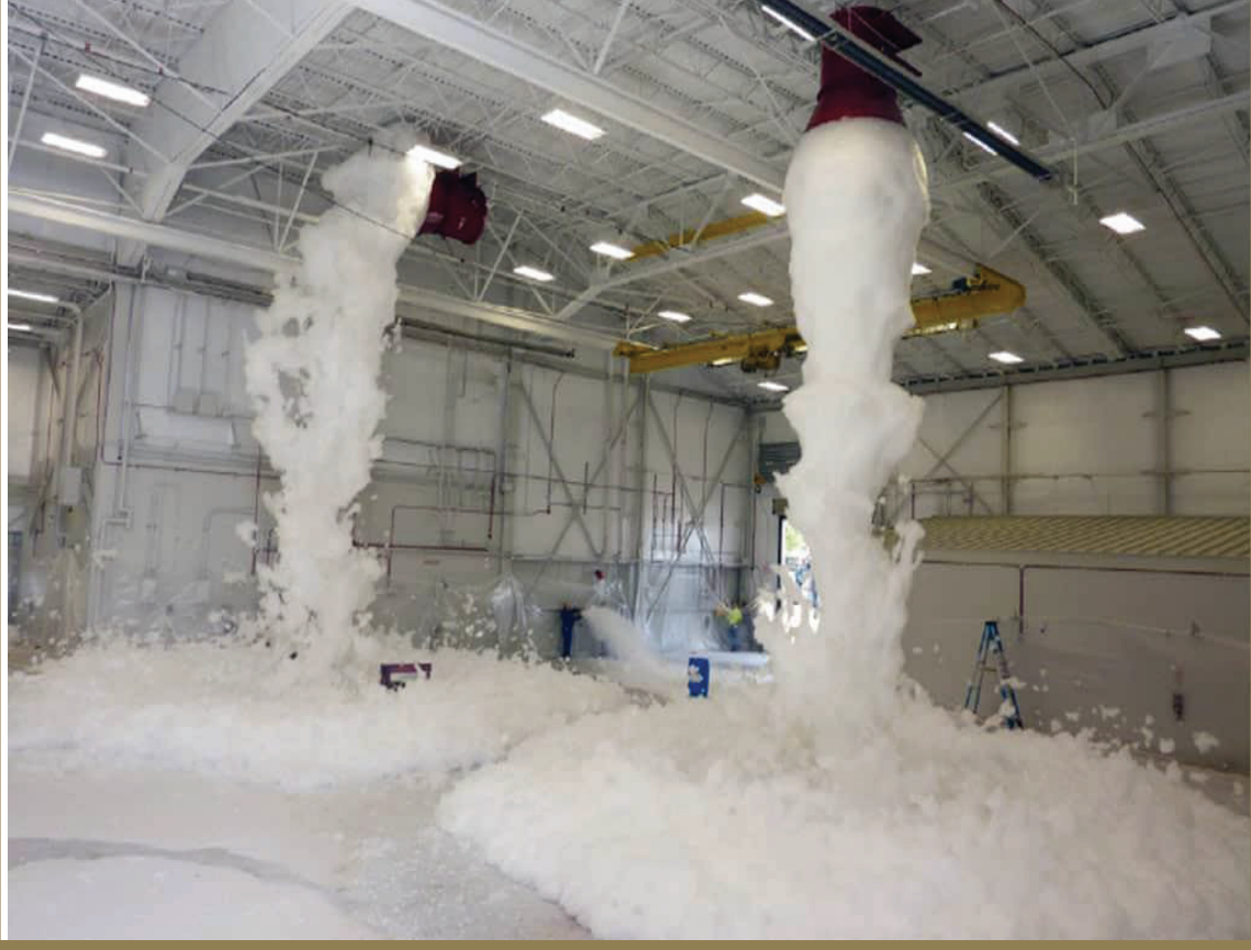
Şekil 1. Bir Uçak Hangarında Köpüklü Yangın Söndürme Sistemi Uygulaması
